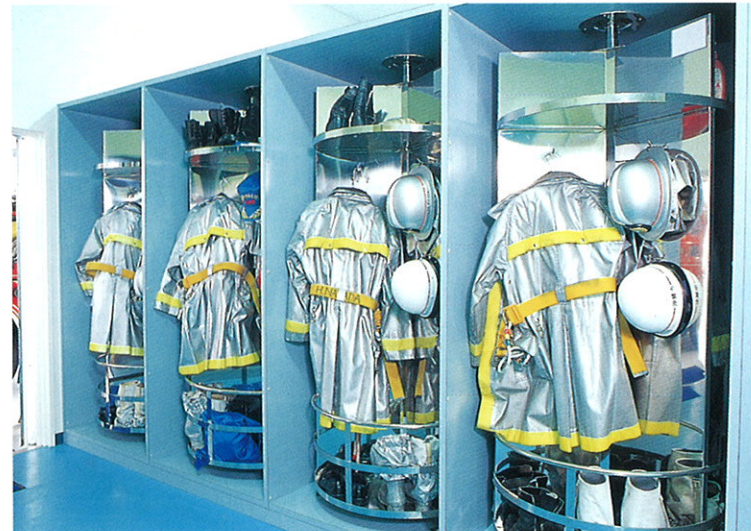
防火衣収納ロッカー
