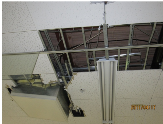
図表 天井落下及び損傷の状況
