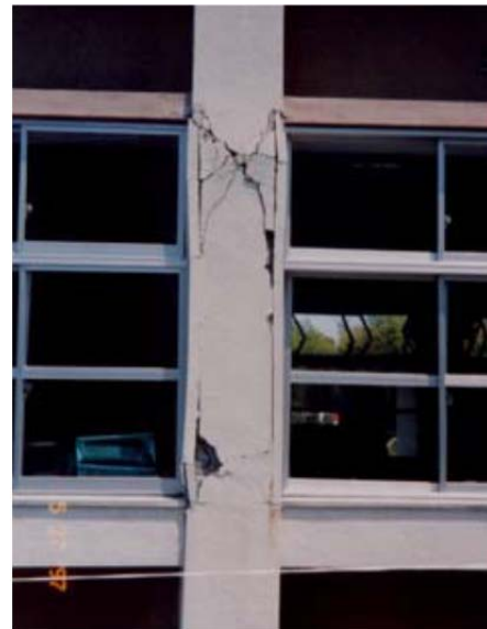
図 震災による構造躯体のひび割れ
