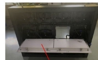
電源、制御基板を一括収納している 防水コンポーネントBOX
