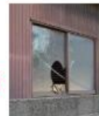
窓が割れた 管理不全空家
