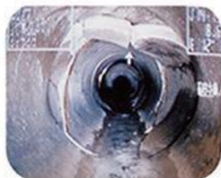
下水道管の破損など
