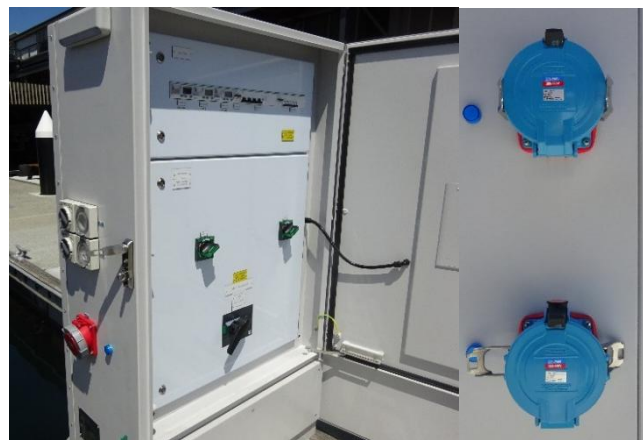
図7 給電・給水ポスト
