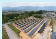
リユース品を使用した発電所
