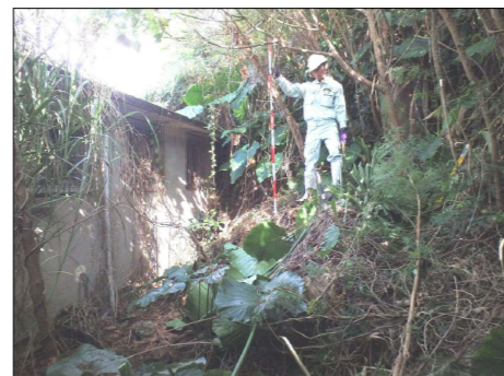
写-6：民家の裏の背後斜面から土砂の押し出しを受けている状況。
