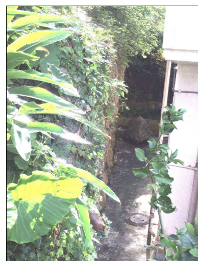
写-5：民間が構築したと思われる石積み擁壁。住宅の脇に転がり落ちたと思われる岩塊を確認。
