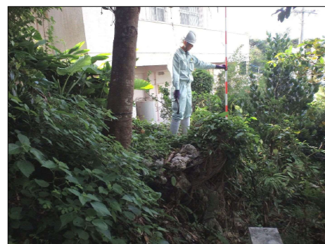
写-4：無対策箇所においては、石灰岩礫が露頭し、下方の住民にとって、非常に危険な状態。
