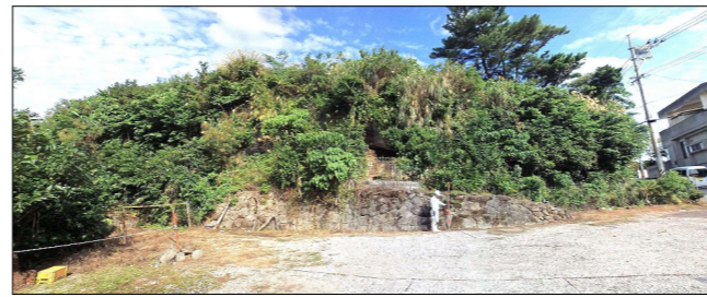
写真-14：公園敷地と駐車場の境界付近には、高さ約0.5~2.0mの石積み壁が存在。石積み壁の継ぎ目に部分的に空隙が見られ、不安定化が進行すると思われる。
