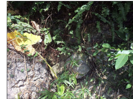
写真-15：一部石積みに緩みが生じている。
