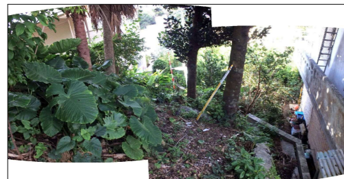
写-3：民地同士境界においては、部分的に擁壁が変状し、部分的に無対策区間を有する。
