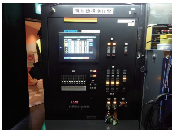
写真：総合操作盤
