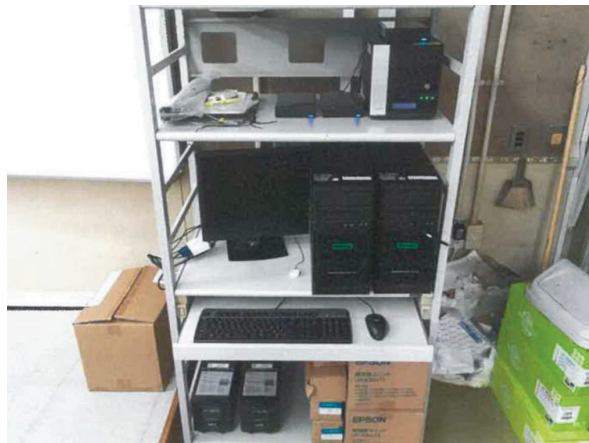
写真：サーバー機器
