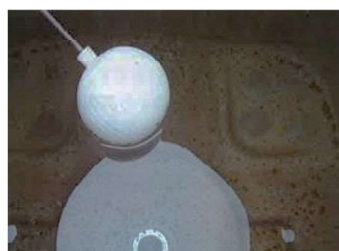
貯水槽の蓋がなく、底に藻が発生している様子
