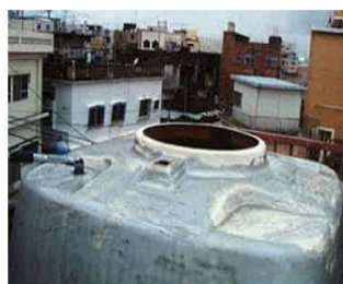
貯水槽の蓋がない状態
