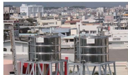
屋上に設置された貯水槽
