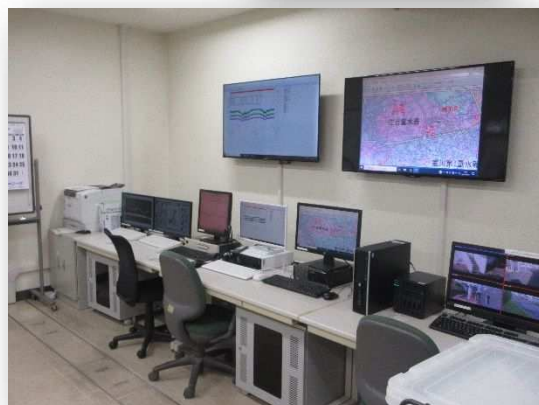
配水ブロック集中管理システム
