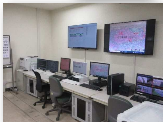
配水ブロック集中管理システム
