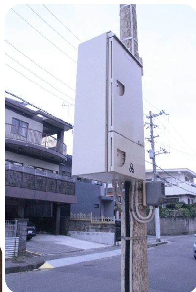
▲配水ブロックデータ送受信機
