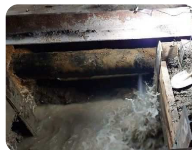
水道管φ400 mm漏水発生現場
