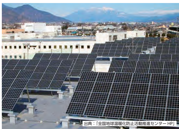
工場屋上の太陽光発電パネルの設置例
